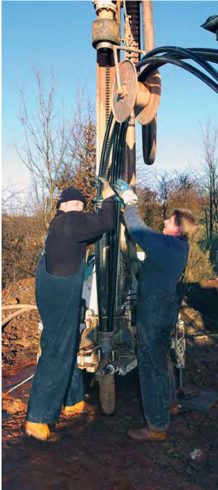
Wärmepumpe und Erdsondenbohrung in Viessmann ge- prüfter Qualität
