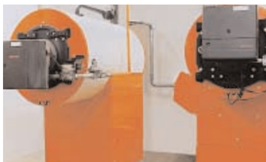
Due Vertomat con funzionamento a gas producono il calore necessario per la stazione di pedaggio.
