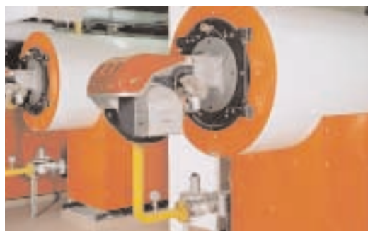
Nel Palazzo Comunale, sede del Municipio, il calore è fornito da due Vertomat da 895 kW e due Paromat-Triplex da 720 kW di potenza.
