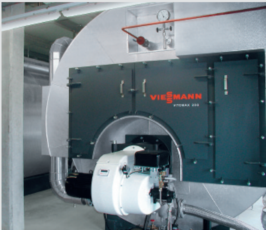
Figura 12: generatore di vapore con un condotto calore di recupero
