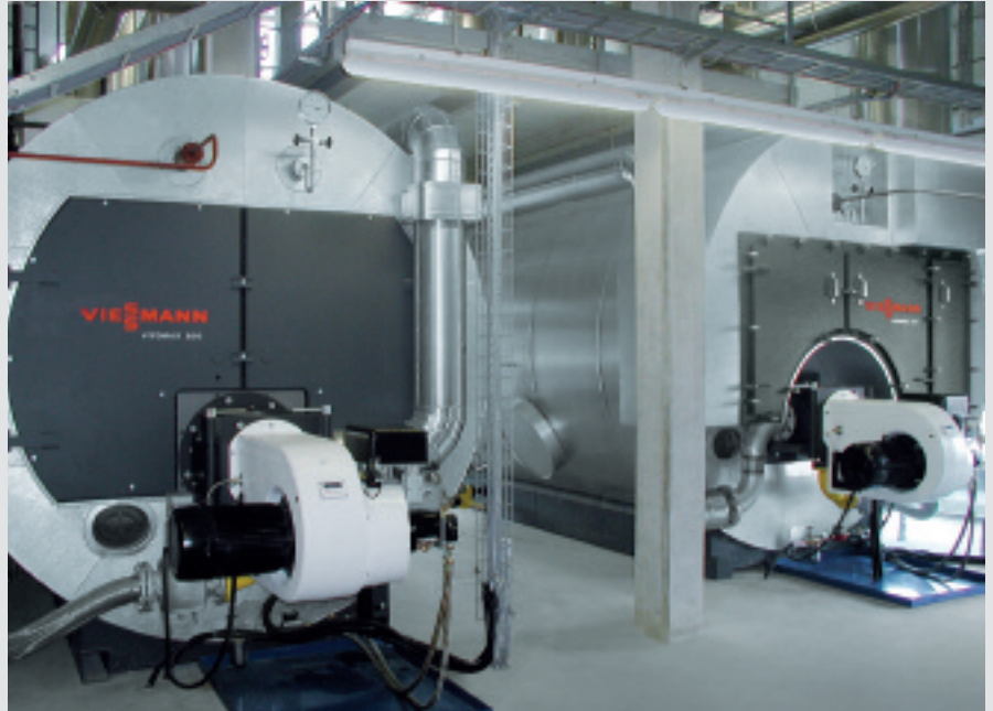
Figura 16: generatore di vapore con utilizzo del calore di recupero, in abbinamento a una caldaia a vapore convenzionale
