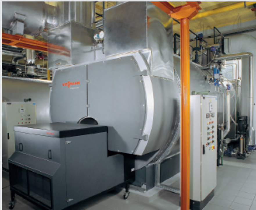
Figura 14: generatore di vapore con due condotti calore di recupero installato in un ospedale
