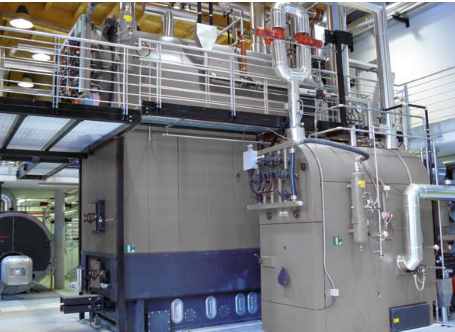
FSR 2100 kW e FSB 550 kW, Vitomax 200 LW 3500 kW Teleriscaldamento, Oberregen (BZ)
