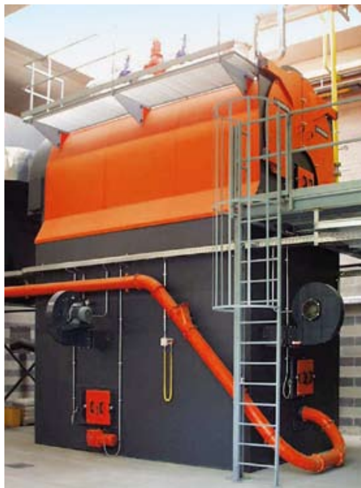
Camera di combustione a insufflaggio FR 3000 Maxalto Spa, Novedrate, Italia (mobilificio)
