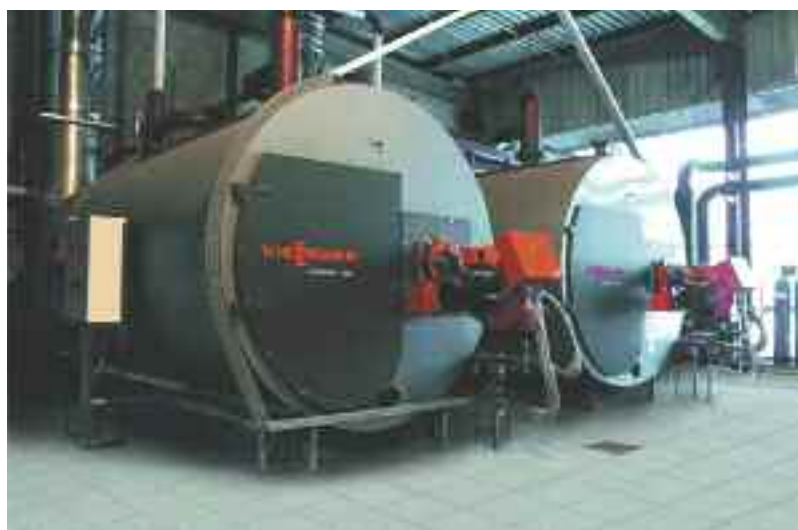
Centrale termica con Vitomax 200-WS
