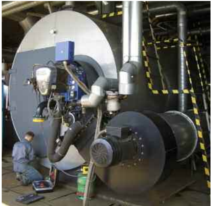
Ispezione circuito di combustione
