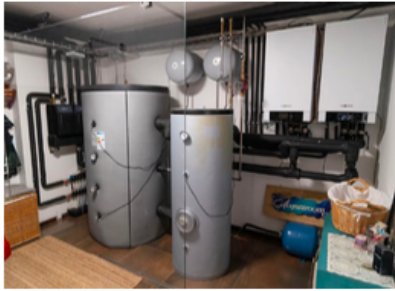
Completa l'impianto un sistema di accumulo da 350 litri per l'acqua calda sanitaria
