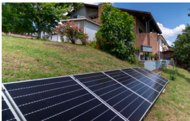
L'impianto è costituito da pannelli fotovoltaici Vitovolt 300 M-WG con una potenza di 400 Wp, che sono in grado di produrre 12,4 kWp
