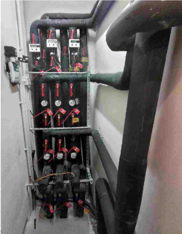
I satelliti d'utenza sono dotati di tutti i dispositivi per la distribuzione dei fluidi termovettori e di contatori per i consumi termici e volumetrici, con sistema di lettura centralizzata automatica
