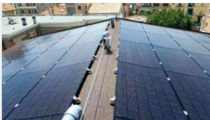
Impianto fotovoltaico condominiale di 4 Energy
