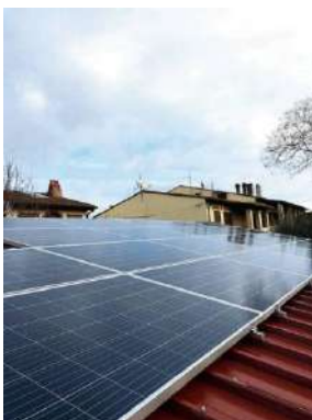
Impianto fotovoltaico installato da Three Energy
