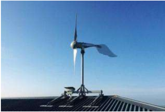
Turbina HAWT1500 di Etneo
