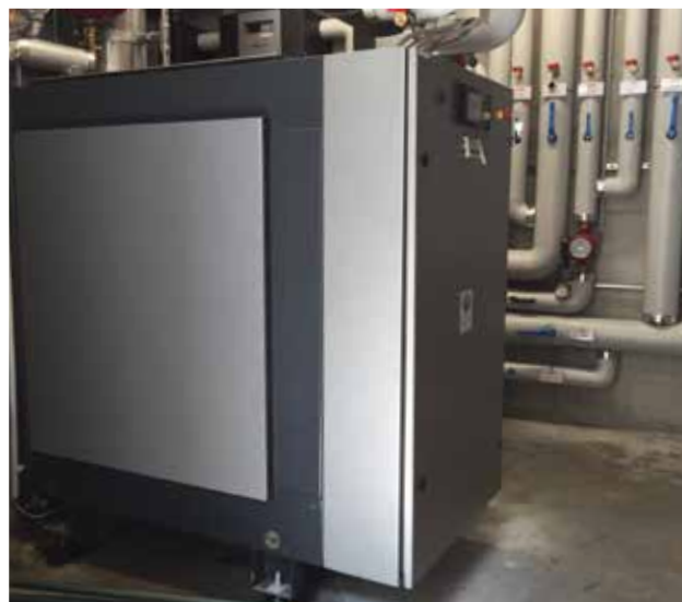
Cogeneratore Vitobloc 200 EM6/15 presso l'Hotel Edenselva
