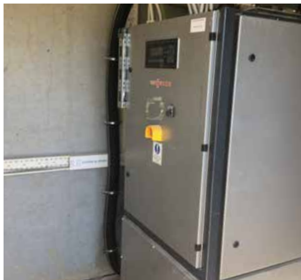
Vitobloc 200 EM-70/115 presso QC Terme Pozza di Fassa (TN)
