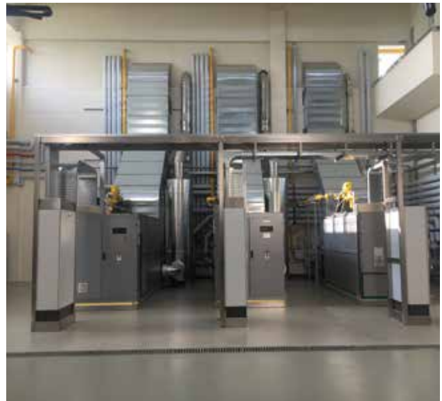
Cogeneratori Vitobloc 200 presso GAI Srl
