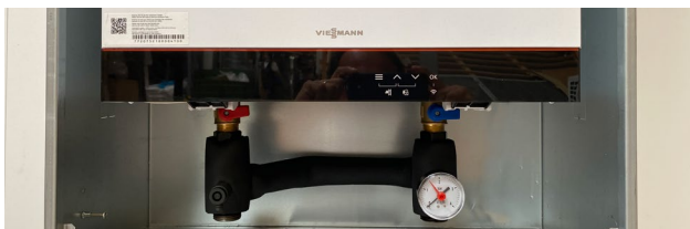
Collettore ibrido installato all'interno del box
