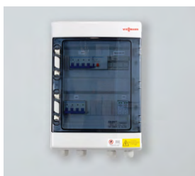
Quadro elettrico Cei 0-21
