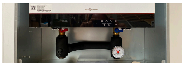
Collettore ibrido installato all'interno del box (sistema Vitodens 100-E Hybrid)
