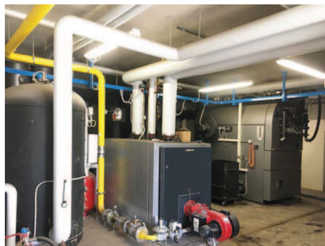
La centrale termica
