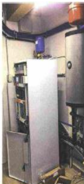
POMPA DI CALORE
