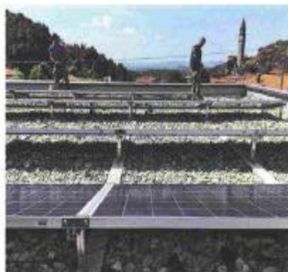
IMPIANTO FOTOVOLTAICO ETETTO ZAVORRATO
