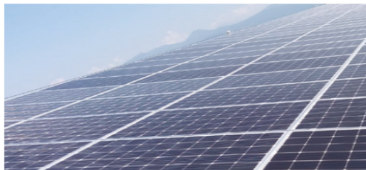
L'IMPIANTO È COSTITUITO DA OLTRE 3MILA MODULI AD ALTA EFFICIENZA VISSMANN, ALLACCIATI A 26 INVERTER HUAWEI E A 6 INVERTER SOLAREDE CON OTTIMIZZATORI. OGNI ANNO L'INSTALLAZIONE PRODURRÀ CIRCA 1,3 GWH
