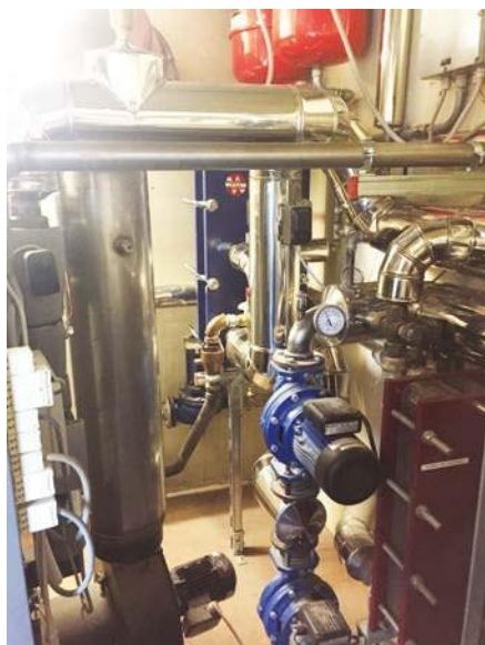
La caldaia Viessman installata si caratterizza per i suoi aspetti innovativi che consentono di ridurre drasticamente le emissioni e di accedere pertanto agli incentivi previsti dal Conto termico 2.0
