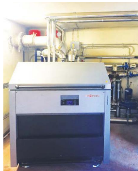
La caldaia a fiamma inversa Viessmann Vitoligno 250-S, modello 85 installata in sostituzione di una a legna
