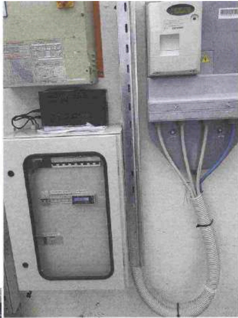
A destra in alto il contatore di produzione installato da E-Distribuzione; a sinistra in basso il quadro interfaccia con il sistema di protezione interfaccia esterno Bytronic, dispositivo di interfaccia e dispositivo di rincarzo; a sinistra al centro UPS di supporto al sistema di protezione interfaccia
