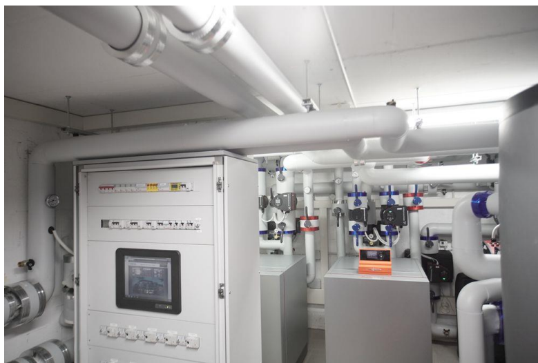
Pompe di calore Viessmann per Casa sul Parco.
