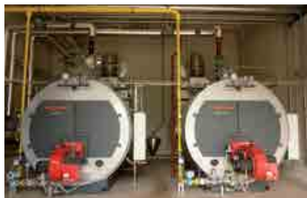
Vista frontale di due caldaie Vitomax HS
